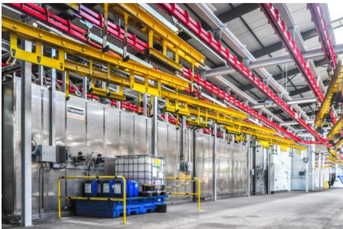
Abb. 8 Anlagenfront mit VBH und Teilepufferspeicher
