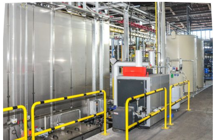
Abb. 3 Vorbehandlungsbereich mit Badheizung und Tanks
