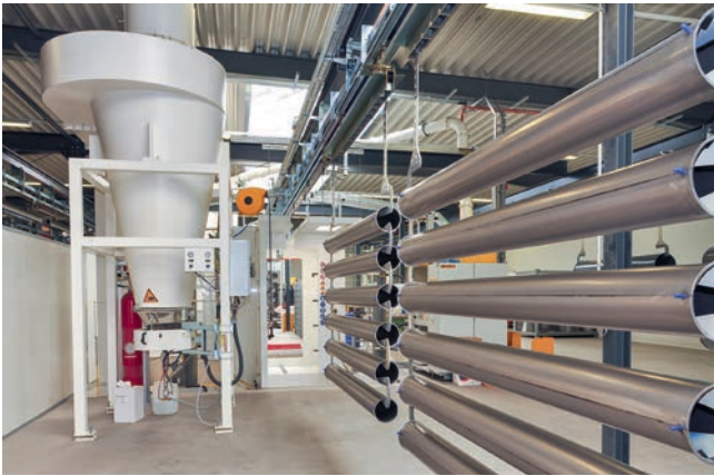
Speicherplätze zwischen Automatikkabine (im Hintergrund) und manueller Beschichtungskabine.
