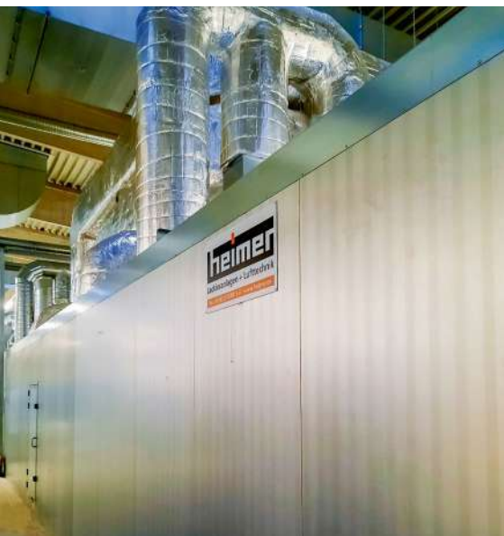
Trockentunnel des Lackrockners von außen.
