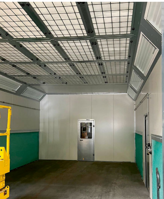
Wärmerückgewinnung und Nacherhitzung tragen zu einer energieeffizienten Luftführung in der Lackierkabine bei.
